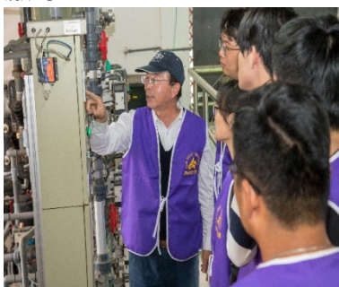
污水處理廠/建置雙薄膜中水回收處理系統， 灌及景觀水池的水源。
