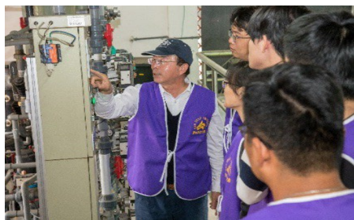
本校污水處理廠/建置雙薄膜中水回收處理
